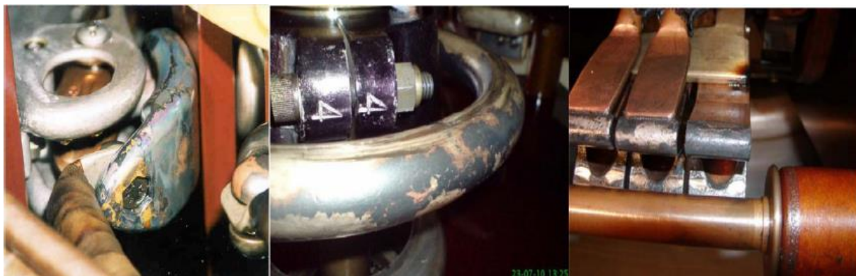
Слика 8. Изглед посребрених елемената трансформатора који су били изложени дејству корозивног сумпора [10].
