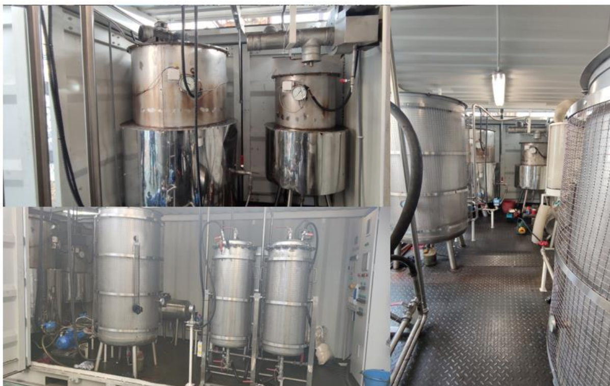
Слика 24. Унутрашњост мобилног постројења
