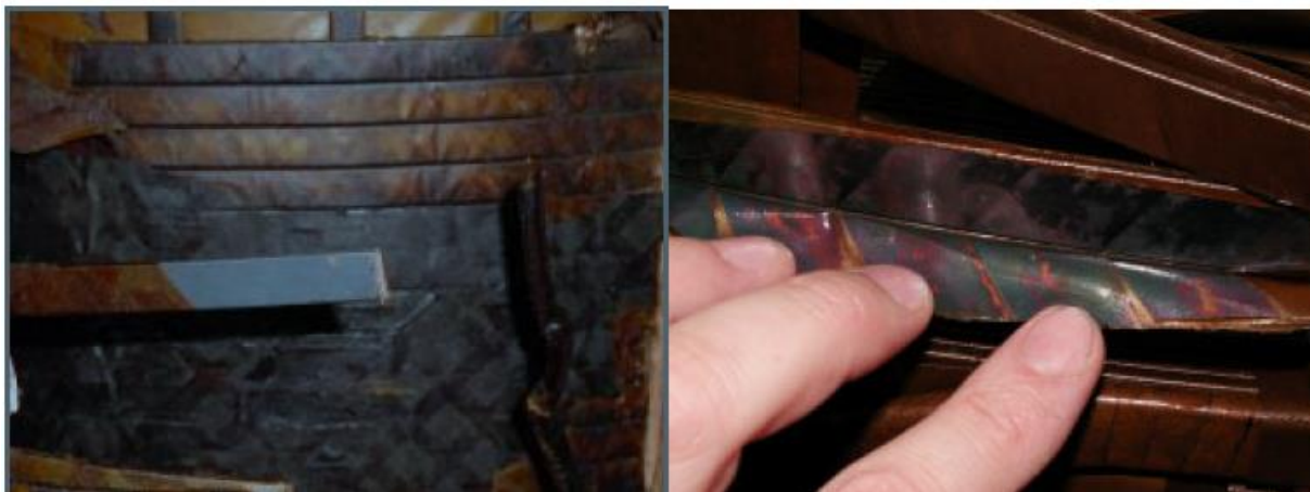
Слика 5. Изглед бакарног проводника и изолационог папира након хаварије трансформатора [38].
