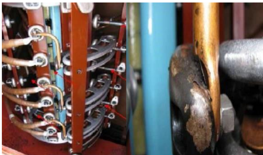
Slika 22. Korozija na srebrnim kontaktima biračkog dela TRP transformatora 150 MVA, 230/130 kV [10].
