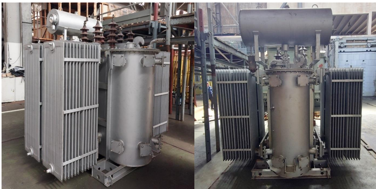
Slika 35. Energetski transformator nominalnog napona 35 kV sa korozivnim uljem, tretiranim sa VSA na terenu [115].
