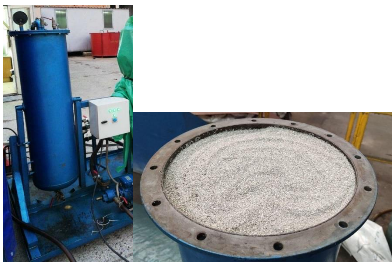
Slika 36. Kolone za obradu korozivnog ulja na terenu, punjene VSA.
