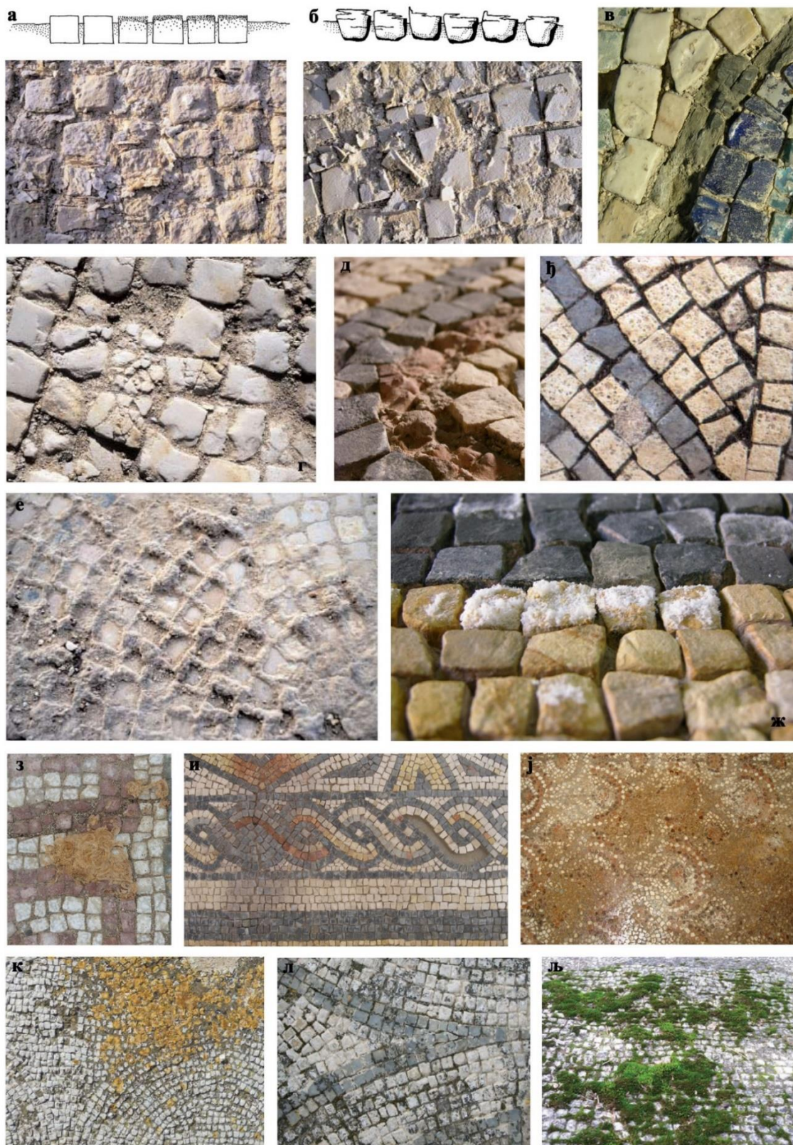
Слика 10. Површинска оштећења мозаика: а) дисагрегација тесера б) деламинација тесера в) љускање тесера г) поломљене тесере д) еродиране тесере е) ошупљене тесере ж) ефлоресценција з) наслаге и), ј) промена боје к), л), љ) микроорганизми на површини теселатума – лишцајеви (к), алге (л), маховине (љ), (Извори: Livia Alberti et al. eds. Illustrated Glossary Technician Training for the Maintenance of In Situ Mosaics , Los Angeles, Tunis: The Getty Conservation Institute, Institut National du Patrimoine, 2013; The Getty Conservation Institute, Mosaics in Situ Project: Illustrated Glossary: Definitions of Terms Used for the Graphic Documentation of in Situ Floor Mosaics , (Los Angeles, UK: The Getty Conservation Institute, 2003; Немања Смичиклас и др. Препоруке за чување и одржавање мозаика (Београд: Друштво конзерватора Србије, Секција конзерватора рестауратора, 2018).
