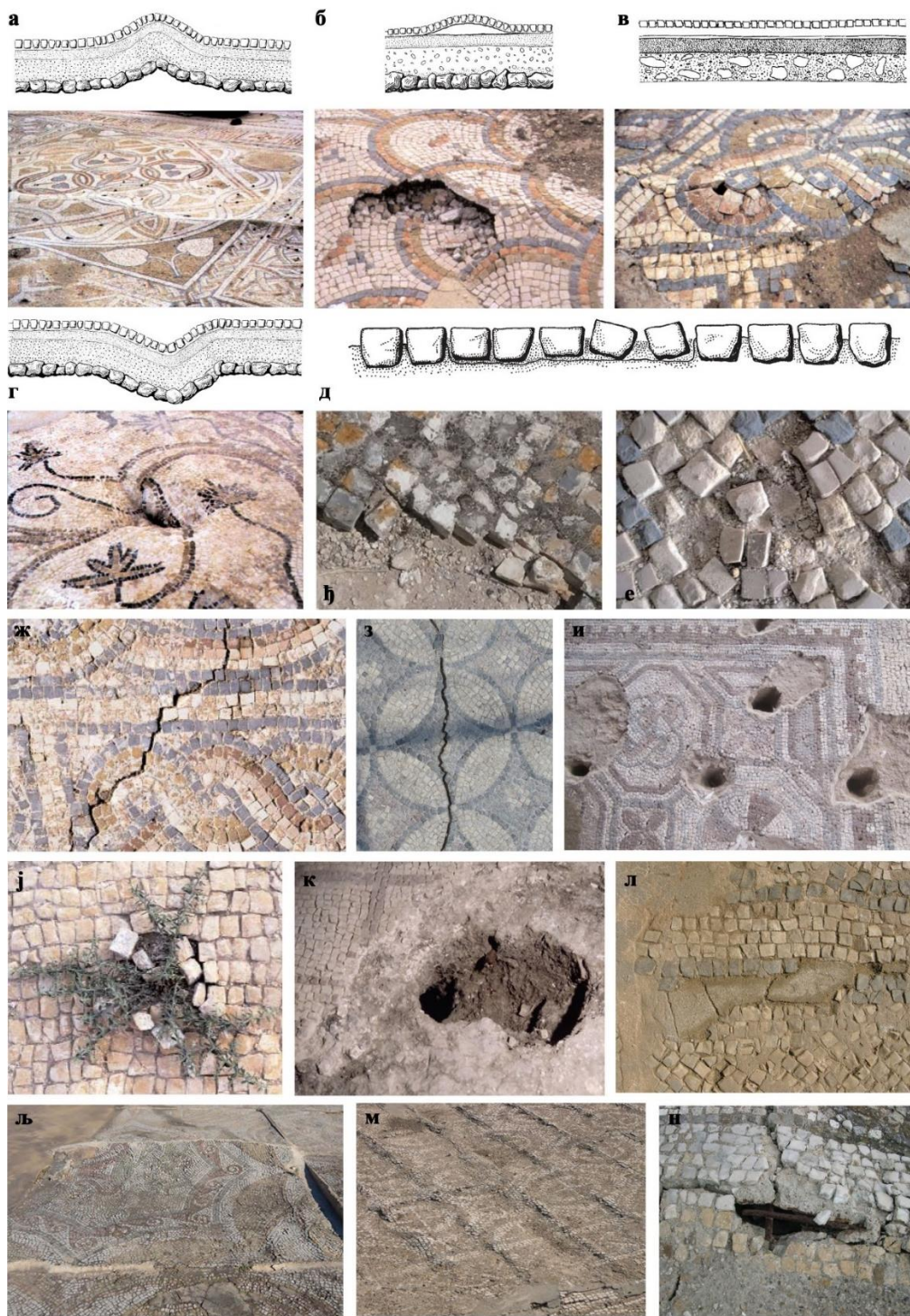
Слика 11. Структурна оштећења мозаика: а) испупчења, б), в) одвајање слојева, г) улегнућа, удубљења, д), њ) нестабилне тесере, е) дотрајали припремни слојеви и нестабилне тесере, ж), з) пукотине, и) лакуми, ј) раст биљака кроз слојеве мозаика, к) копање тунела штеточина, л) оштећења изазвана каснијим интервенцијама – цементни малтер за стабилизацију, љ) оштећења изазвана каснијим интервенцијама – оштећење подлоге – деформације панела носиоца, м) оштећења изазвана каснијим интервенцијама – деформација аб подлоге изазване арматурном Q мрежом, н) оштећења изазвана каснијим интервенцијама – деформација аб подлоге изазване арматурном Q мрежом – денивелације – избочине – напрснућа. (Извору: Livia Alberti et al. eds. Illustrated Glossary Technician Training for the Maintenance of In Situ Mosaics, Los Angeles, Tunis: The Getty Conservation Institute, Institut National du Patrimoine, 2013; The Getty Conservation Institute, Mosaics in Situ Project: Illustrated Glossary: Definitions of Terms Used for the Graphic Documentation of in Situ Floor Mosaics , (Los Angeles, UK: The Getty Conservation Institute, 2003; Немања Смичиклас и др. Препоруке за чување и одржавање мозаика (Београд: Друштво конзерватора Србије, Секција конзерватора рестауратора, 2018).
