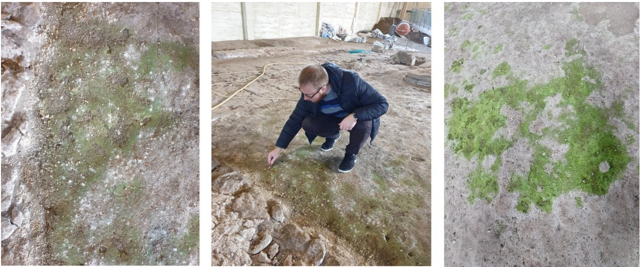
Слика 45. Идентификовано присуство зелених алги које су показатељ прилива воде/влаге из земље и високих вредности релативне влажности ваздуха у објекту, (Извор: Аутор).
